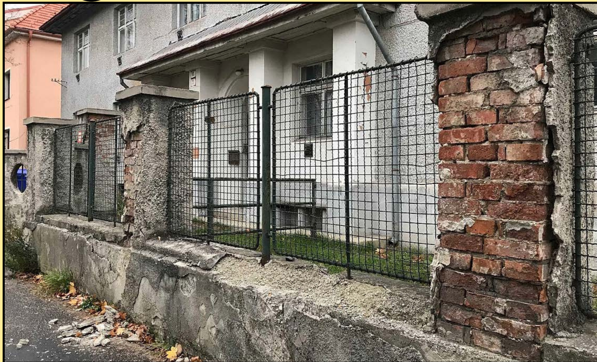
Budova v zlom stave
