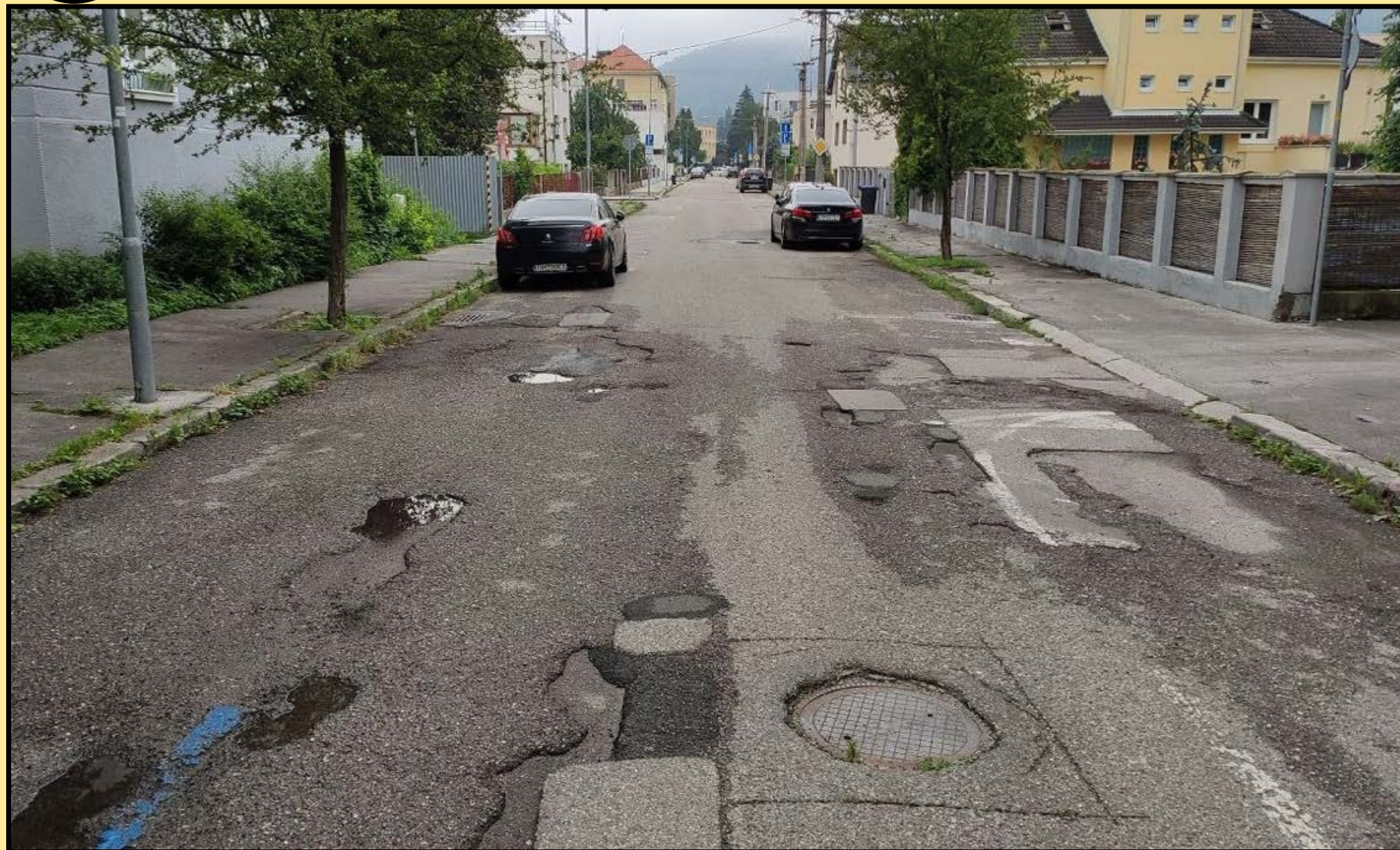
Rozbitá cesta - větší úsek
